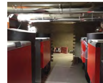
Calderas de biomasa
